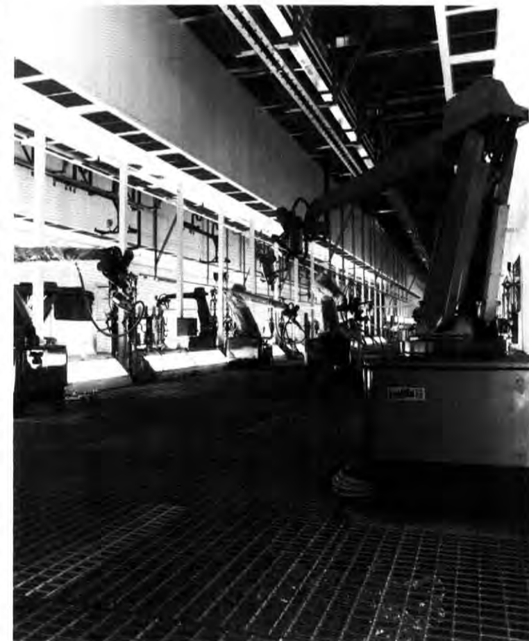
PVC-Unterboden-Spritzkabine. Roboter übernehmen hier Aufgaben, die an der entsprechenden Stelle des alten Lackierereikomplexes in Überkopparbeit von Hand erledigt werden mußten.
