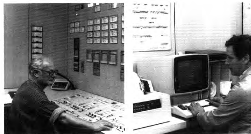
Mitarbeiter Günther Loitz am Leitstand von Kessel II bei der Überprüfung der Betriebsfunktionen. Die wirtschaftlichste Fahrweise der Energieanlagen wird durch ein Optimierungsprogramm ermittelt; auf dem Bild rechts am Datensichtgerät Mitarbeiter Gerhard Thiel.
