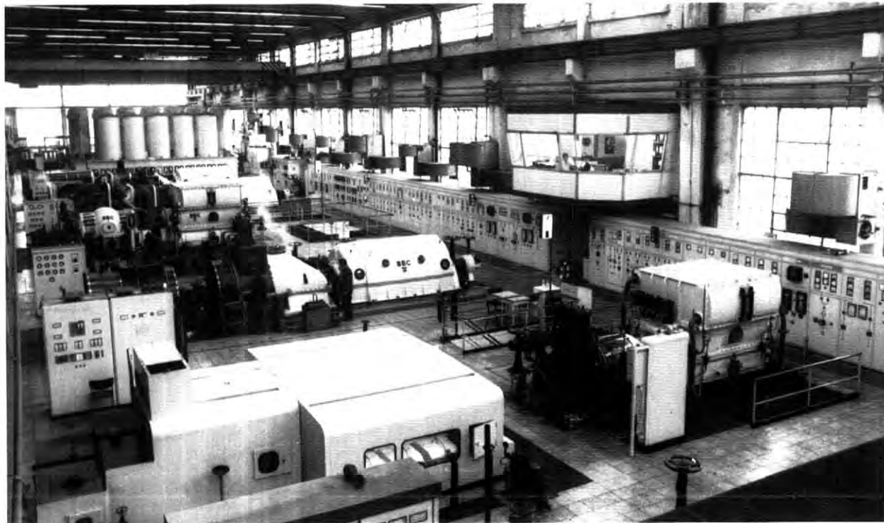
Blick ins Maschinenhaus des Rüsselsheimer Kraftwerks M 3.
