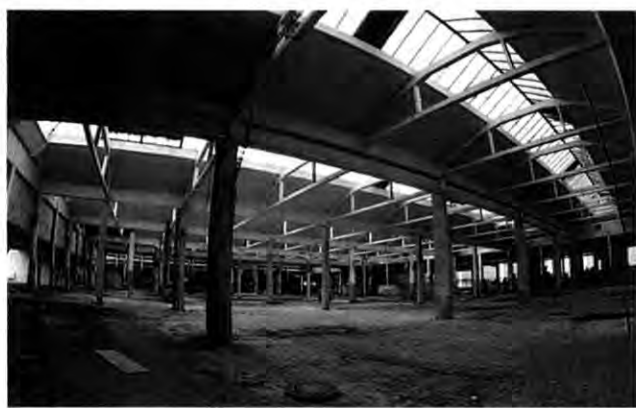
Platz da: Vom alten Gebäude stehen nur noch die Außenmauern
