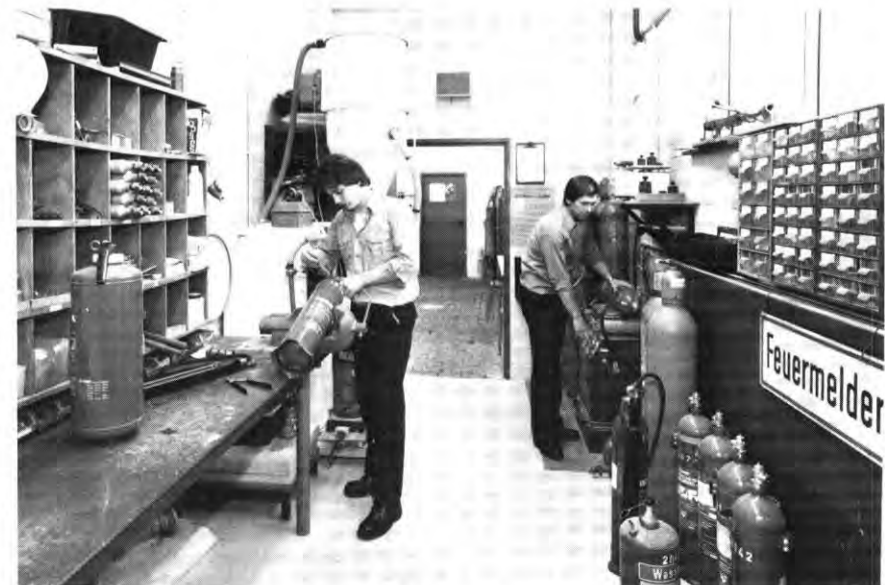
Die Mitarbeiter der Werkfeuerwehr E. Gmeinwieser und K. Rühl (von links) beim Prüfen und Füllen von Handfeuerlöschern.
