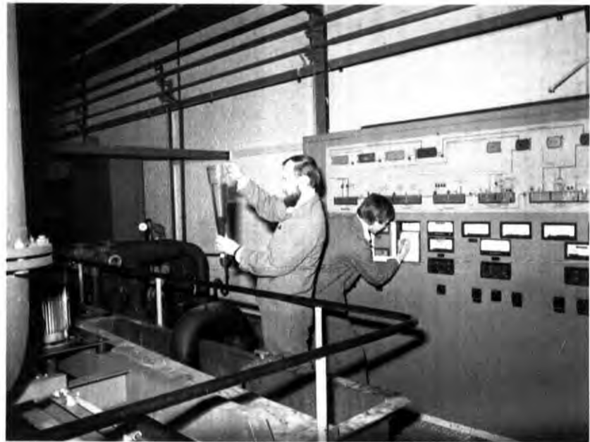
Blick in die Bohrwassertrennanlage. Links Mitarbeiter A. Sommerfeld bei der Durchführung einer Schlammabsetzprobe und rechts Mitarbeiter G. Klarl beim Eichen der Meßsonden bzw. Auswerten der Meßergebnisse.
